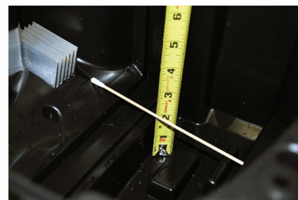
Eau de condensation accumulée dans le conduit d'air
